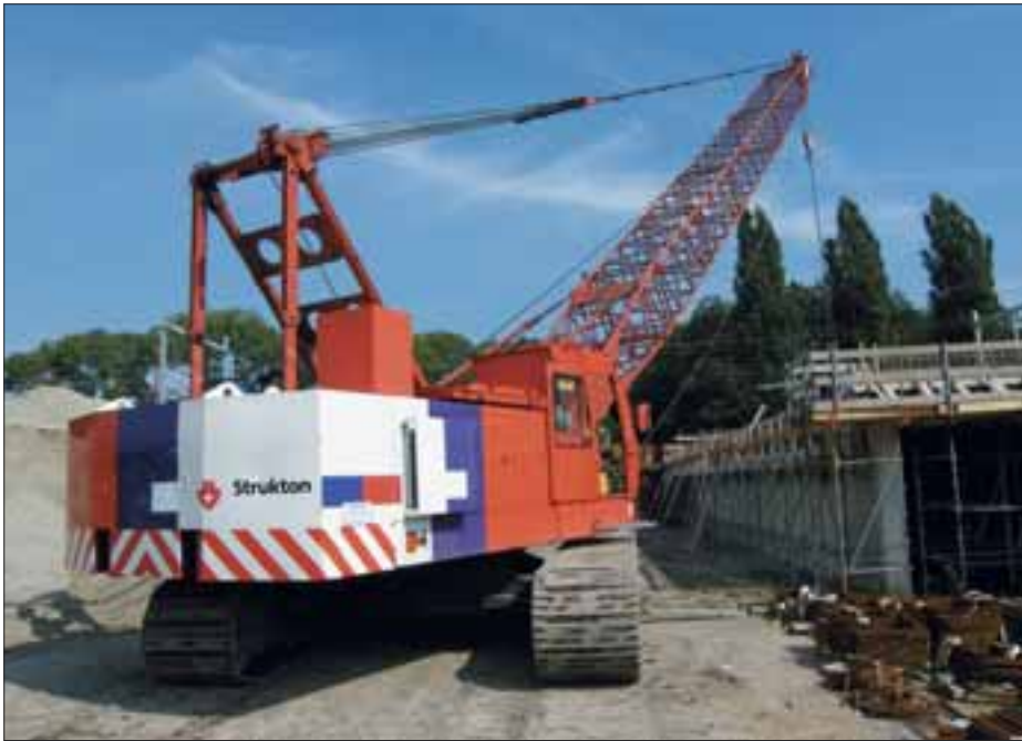
Een KH125 van Strukton werkzaam aan een nieuw spoorviaduct (Vaartse Rijn - Utrecht).
